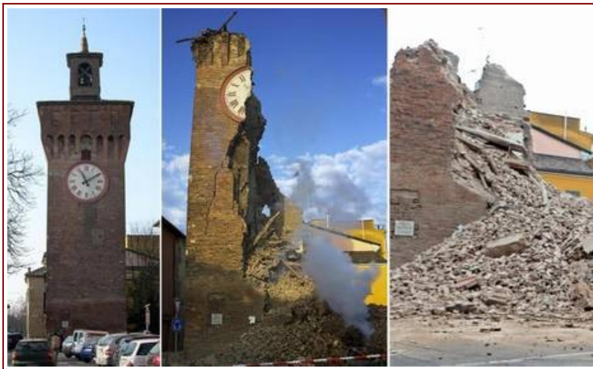
Il campanile di Finale Emilia, prima del terremoto del 20 maggio 2012, durante e dopo.
