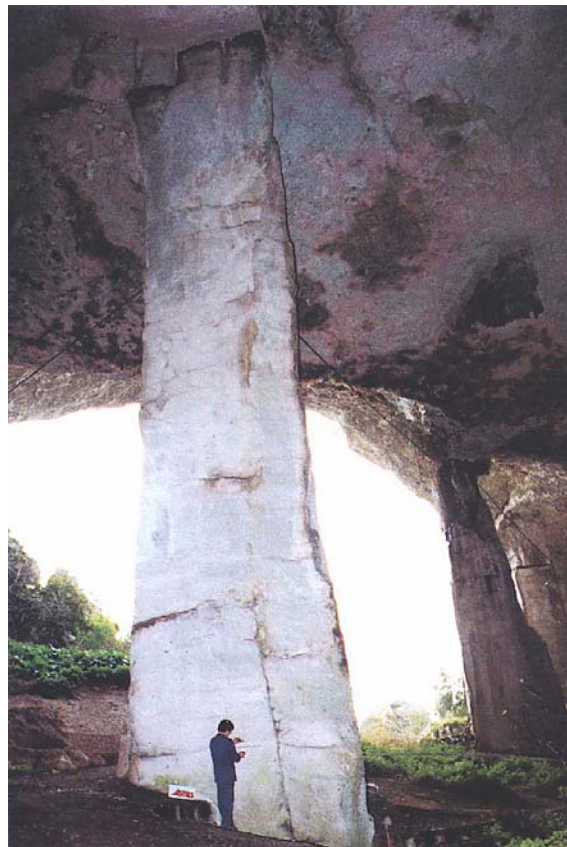
Misura dello stato tensionale in uno dei pilastri centrali della grotta dei Cordari. Nella pagina a fronte: a sinistra, misura dello stato tensionale sulla struttura perimetrale della grotta dei Cordari. A destra, planimetria della grotta dei Cordari. E' possibile leggere nella pianta l'ubicazione delle prove e i valori di sollecitazione misurati.
