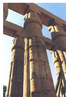
In alto, colonne del cortile di Amenofi III nella fase di smontaggio. Qui sopra, esempio di degrado della pietra del tempio di Luxor.
