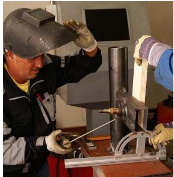
Controllo dell'angolo di 4 gradi per distanziare le pale dal sostegno, prima della saldatura definitiva della staffa sul tubo di imbardata.
